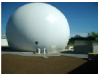
Red de suministro de Biogás a las Calderas - CCU Temuco
