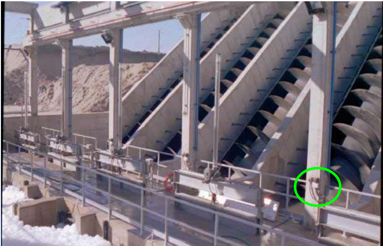
Fig. 4: Tornillos de Arquímedes – PTAS La Farfana (Aguas Andinas) – Santiago de Chile. En este ejemplo se ha conservado el espacio para poder limpiar en forma cómoda. Se destaca la presencia de botoneras de parada de emergencia (callampas de color rojo) para cada tornillo. Este concepto de seguridad es muy común en la ingeniería de aguas servidas, pero por decisión de ahorro o por desconocimiento, no se aplica siempre...
