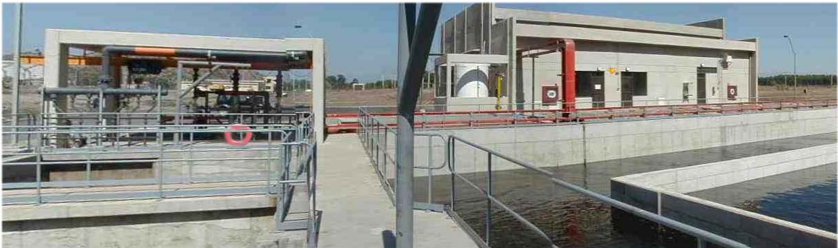
Fig. 1: Ejemplos de Elementos de Protección en la Planta de Cloración de la PTAS El Trenal (A.Andinas) – Santiago: Las barandas alrededor del canal de cloración y de los estanques de contacto protegen de caídas de personas u objetos. Traten de ubicar también el flotador salva vida, la ducha de emergencia al lado del estanque de químico, las dos mangueras de incendio, dos pescantes de izaje, un monorriel para tecele, las ventanas para visión externa antes de penetrar en las salas de cloración, y el advertidor luminoso de escape de gas cloro.
