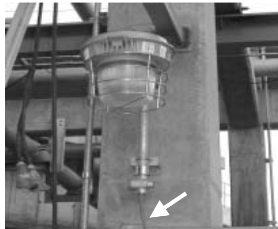
FOTOGRAFIA 2: A pesar de utilizar una lámpara y caja de conexionado EEx, el cableado sin protección no es conforme (ver la fotografía precedente).
